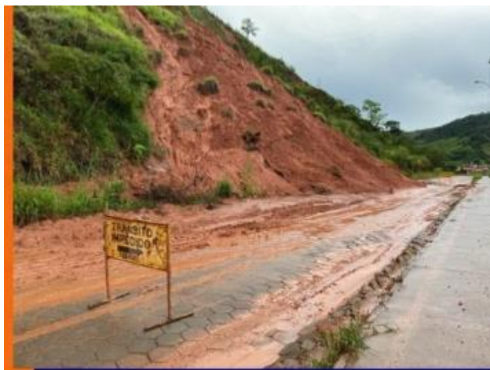
Figura 3 – Deslizamento na via de acesso ao bairro Triângulo
