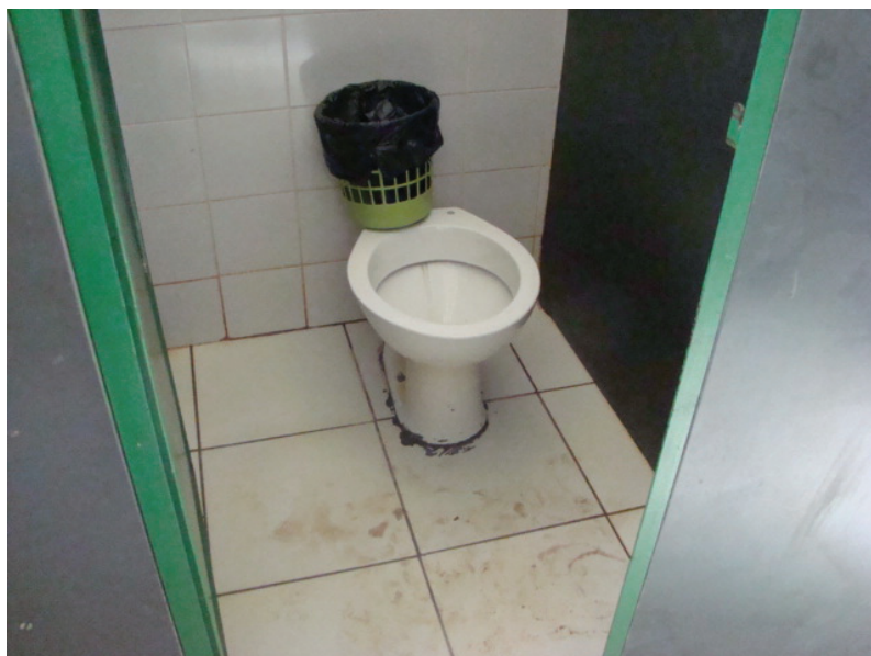
Figura 3 - Banheiro da escola municipal que devido ao período de estiagem, estava sem água para limpeza do ambiente e higienização pessoal.
